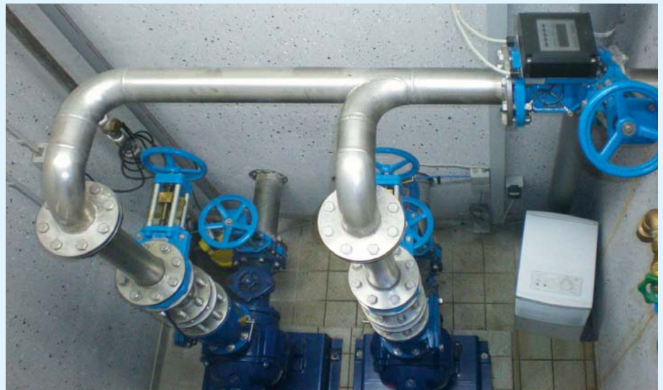
Bild 1 Maschinenraum der Pumpstation Greifenberg: Fehlender Arbeitsraum ergibt eine ungünstige Bewertung für die Betriebstechnik.
