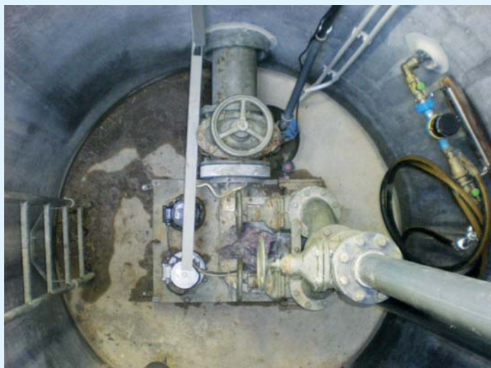
Bild 6 Maschinenraum der Pumpstation Dießen: Eingeschränkte Betriebstechnik durch zu geringe Abmessungen, mangelhafte Bauausführung.
