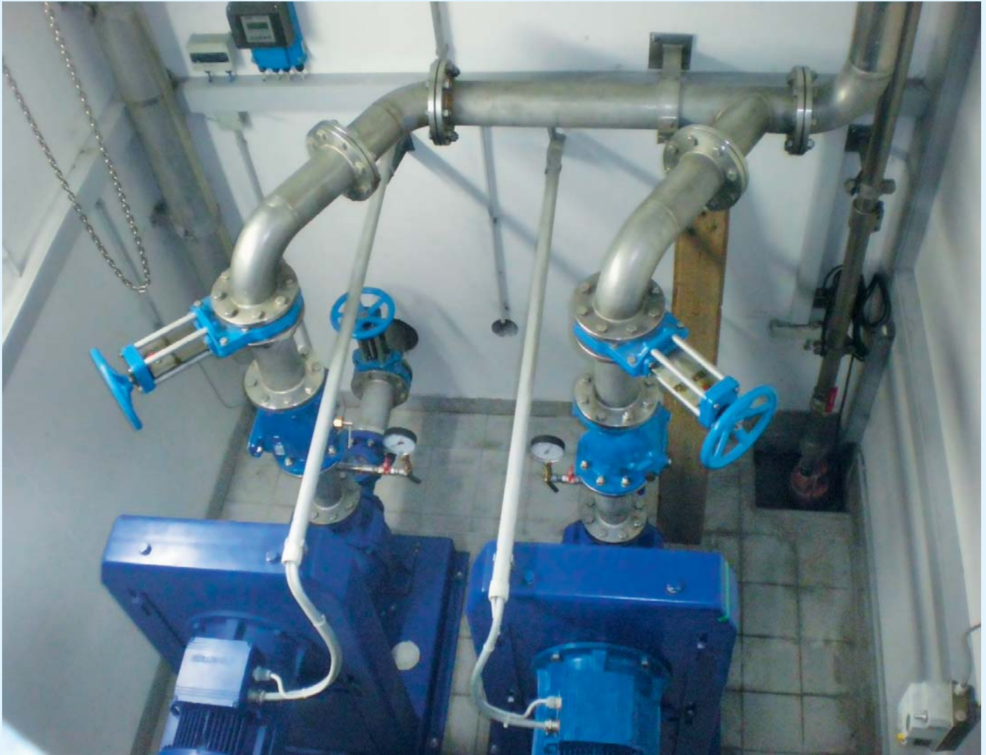
Bild 2 Maschinenraum des Pumpwerks Beuern: Geringe Bauwerksabmessungen beeinträchtigen die Betriebstechnik, der Wasserzähler ist schlecht erreichbar. Der Energieverbrauch der Pumpen ist deutlich zu hoch.
