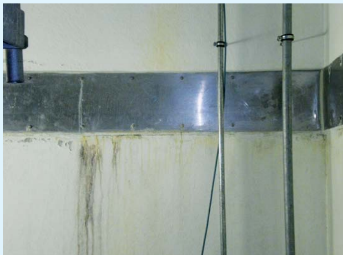
Bild 5 Undichte Fugen zwischen den Beton-Fertigteilen bei der Pumpstation DZ04
